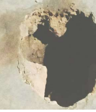
कहा कि छोटा गोफ देखकर पहले लगा कि बूढ़ा ने मिट्टी खोदा होगा, लेकिन धीरे-धीरे गोफ का दायरा बढ़ने लगा। स्थानीय सालडांगा निवासी मिथुन बाउरी ने कहा कि न्यू केंदा ओसीपी में ब्लास्टिंग के कारण भू-धंसान की घटना घटित हुई है। उन्होंने कहा कि भू-धंसान के कारण बने गोफ का दायरा
